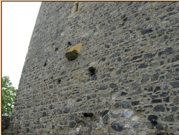
Radyně (2009) Zdivo zříceniny Radyně je postaveno z buližníkových bloků z okolí vrcholu koce Radyně.
